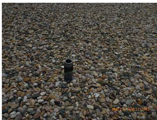
25-082-50 (N. vent pipe)
