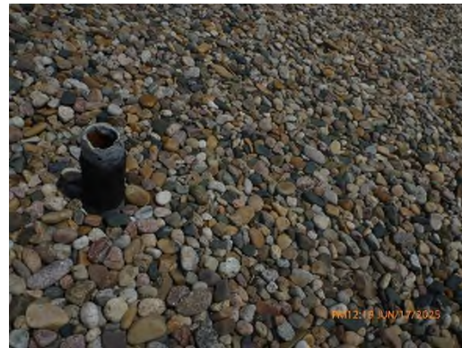
25-082-52 (S. vent pipe)
