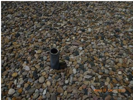
25-082-51 (N. vent pipe)
